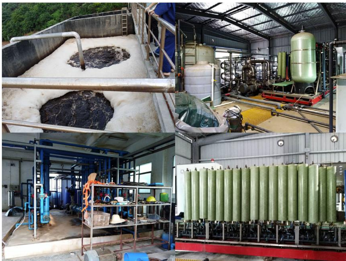
图 3.6.1-3 耒阳垃圾卫生填埋场渗滤液处理
